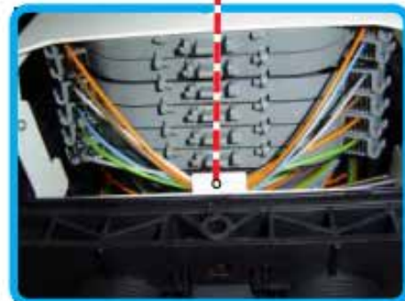
Vue de l'arrière des cassettes Seen from behind the trays
