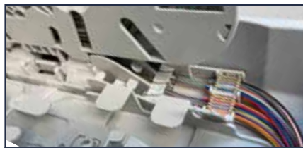
Pigtails bien ordonnés en entrée de cassettes d'épissage avec un accès intuitif
