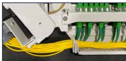
Cordons optiques guidés sur le côté, protégés par un volet avec une étiquette de repérage des connecteurs
